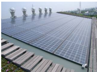
■太陽光発電パネルおよび採光システム■
